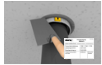
Brandsicherer Verschluss und Kennzeichnung.
